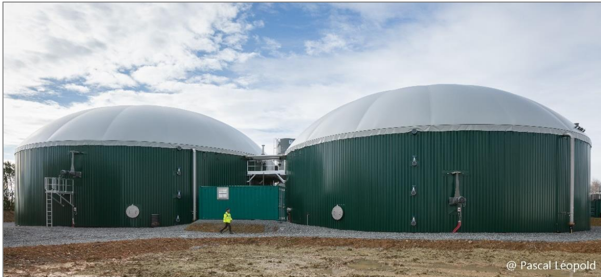
Photographie 10 : Exemple d'ouvrages de digestion (Source : ENGIE BioZ)
